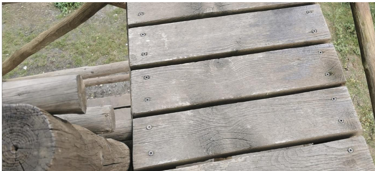
Obrázek 45: Prvky poškozené působením abiotických degradačních činitelů (Zdroj: Autor práce)
