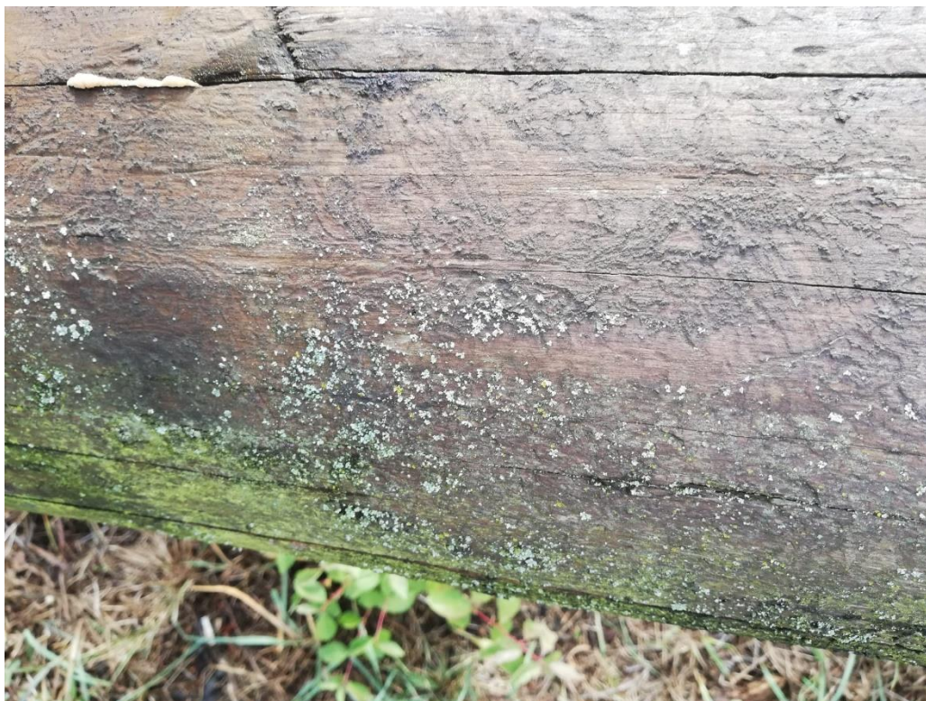
Obrázek 41: Plíseň na prvku rozhledny (Zdroj: Autor práce)
