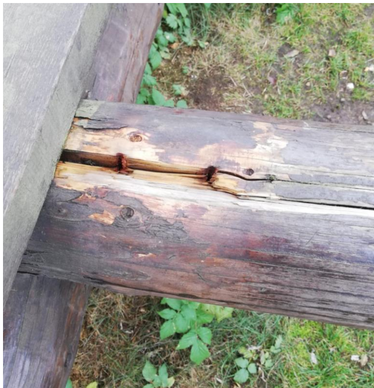
Obrázek 46: Trhlina na prvku rozhledny (Zdroj: Autor práce)
