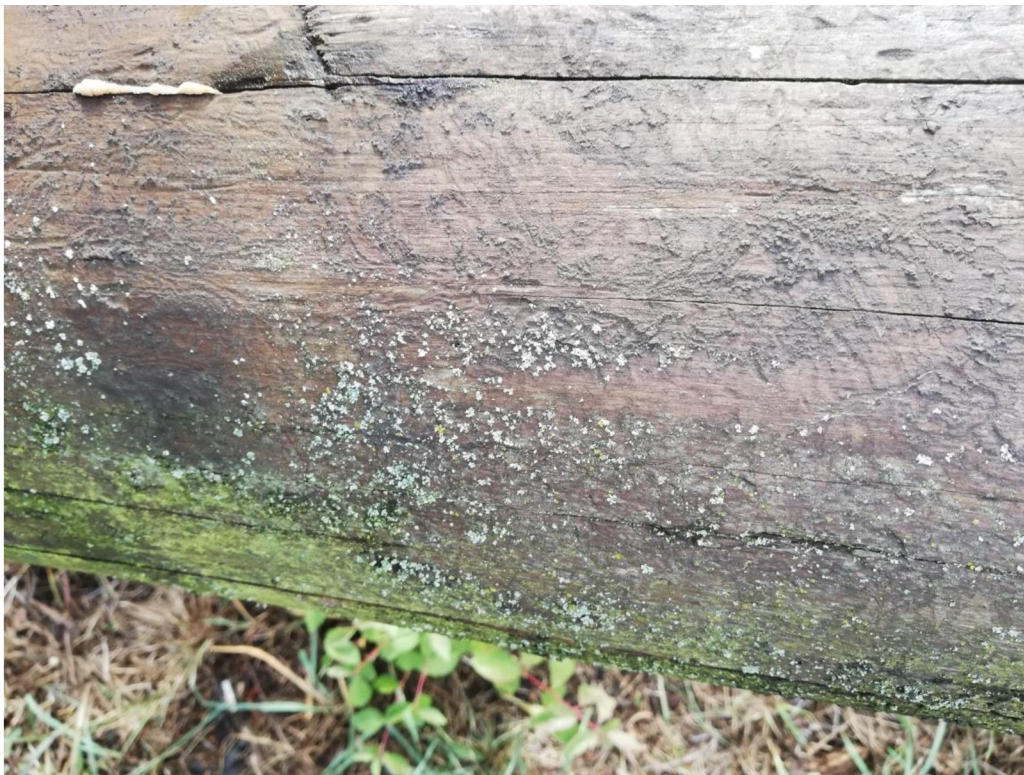
Obrázek 41: Plíseň na prvku rozhledny (Zdroj: Autor práce)
