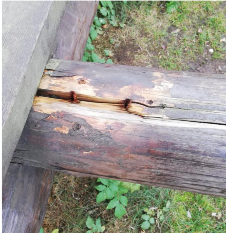
Obrázek 46: Trhlina na prvku rozhledny (Zdroj: Autor práce)
