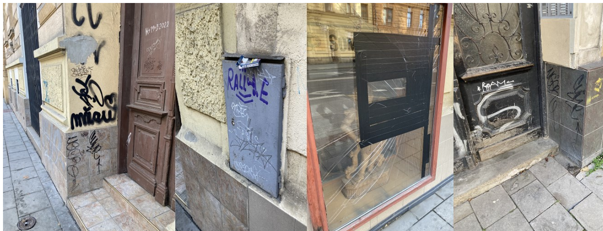
Obrázek 53: Projevy vandalismu v ulici Komenského
