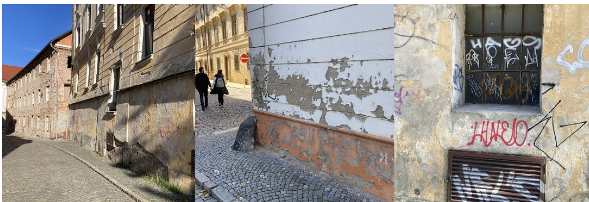
Obrázek 56: Degradované domy v ulici Akademické
