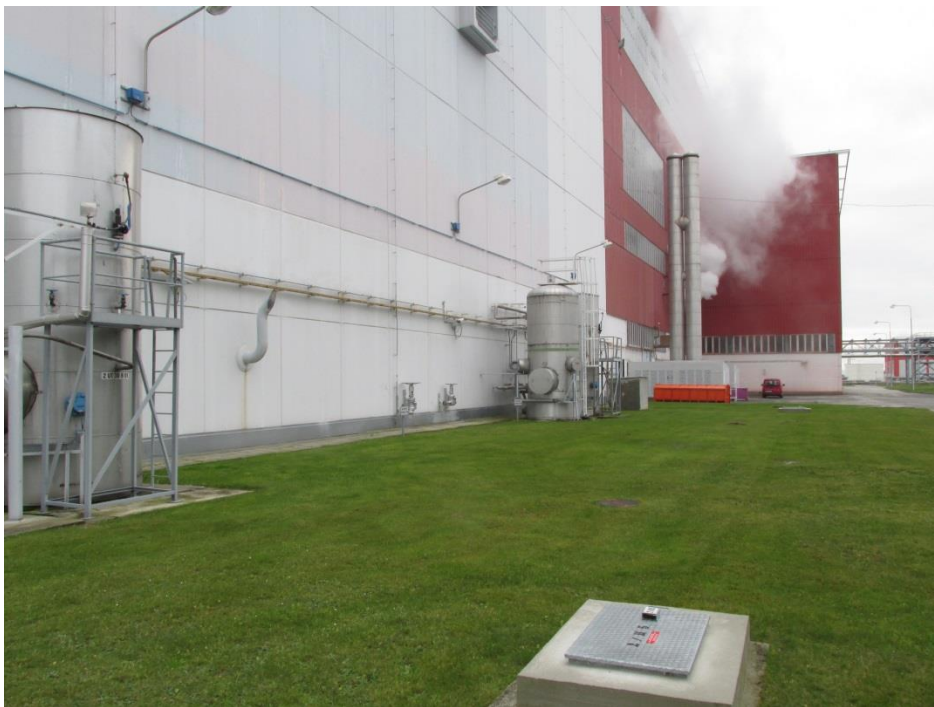
Obrázek 10 Umístění armatur na západní straně obestavby
