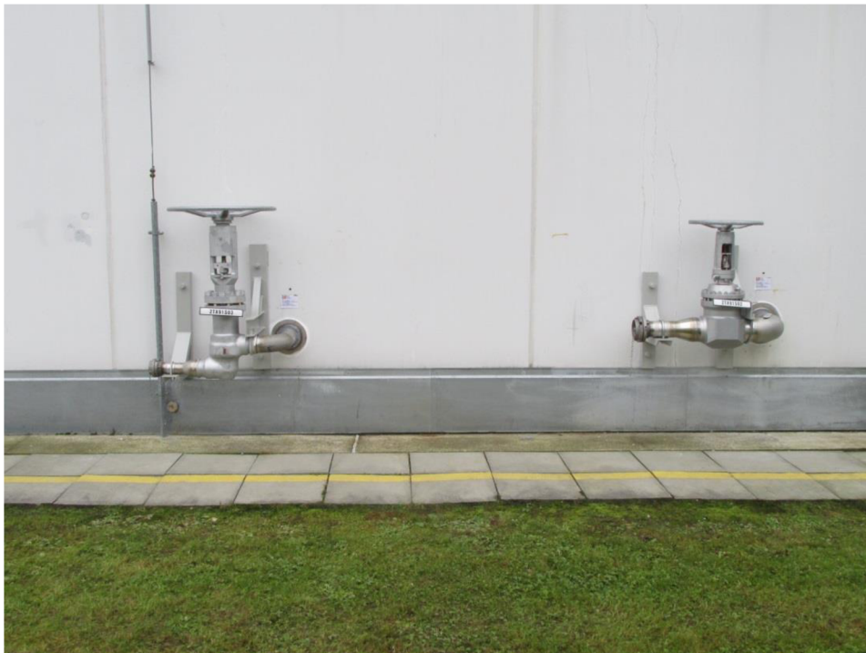
Obrázek 9 Pohled na připojovací armatury z vnější strany obestavby
