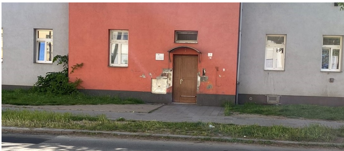
Obr. 13: Poničená fasáda jednoho z domů na Husově ulici. Zdroj: vlastní archiv autora (viz Příloha 4).
