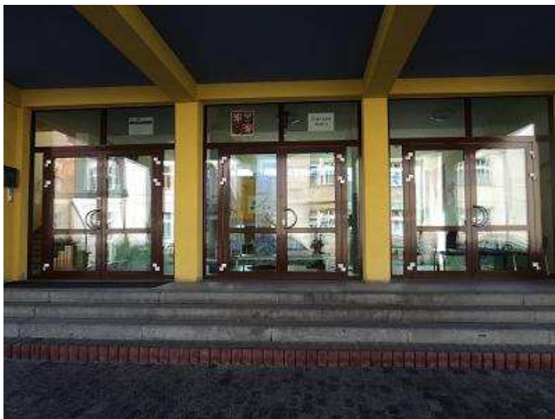
Obrázek č. 2 – Základní škola Grünwaldova Ukázka absence bezbariérového přístupu
