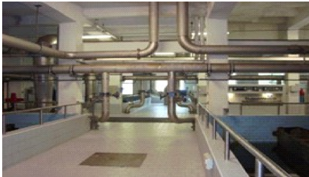
Foto č. 8 Úpravna vody Meziboří (SVS, 2012)
