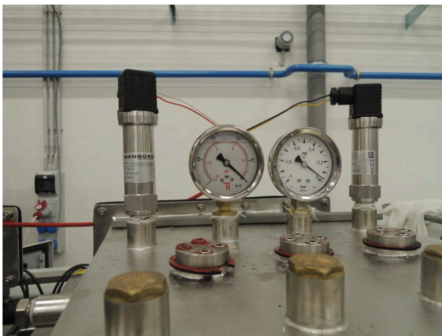
Obr. 5.4 Snímače tlaku (na bocích) a manometry (uprostřed)
