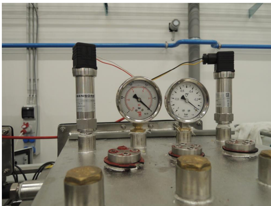
Obr. 5.4 Snímače tlaku (na bocích) a manometry (uprostřed)
