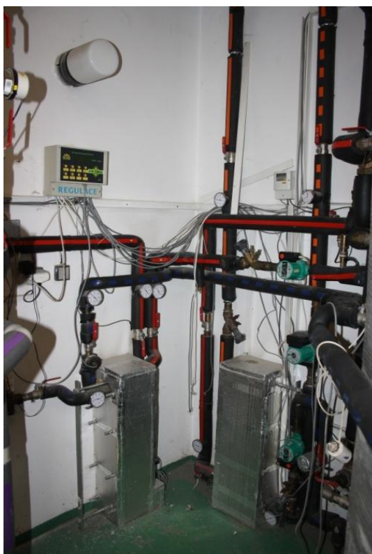
Obr. 26 – Pohled na výměníky a další infrastrukturu [fotografie autor]
