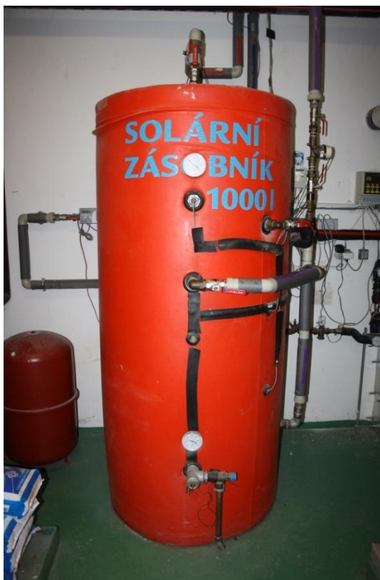
Obr. 25 – Solární zásobník 1000 l [fotografie autor]
