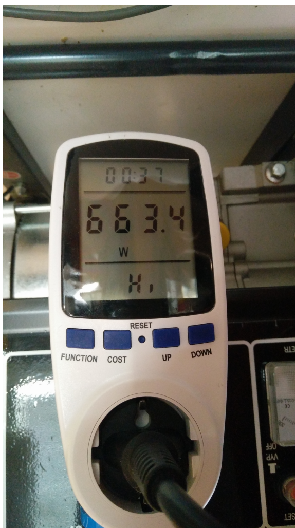
Obr. 19: Výkon generátoru před přestavbou
