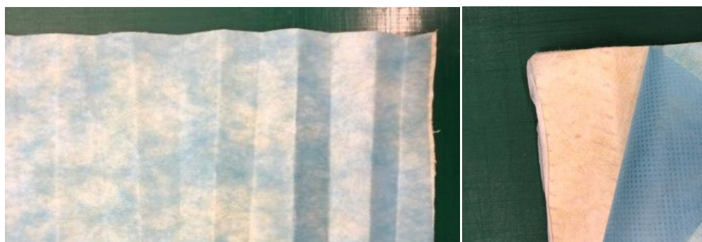
Obr. 33 a Obr. 34 Po uvolnění. Částečné odlepení krycí vrstvy.
