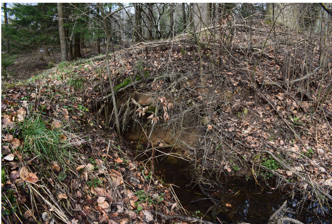
Nátrž hráze - detail, březen 2023.
