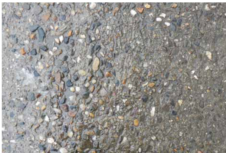
Obr. 1.3: Povrch betonu porušený mrazem a rozmrazovacími prostředky [15].
