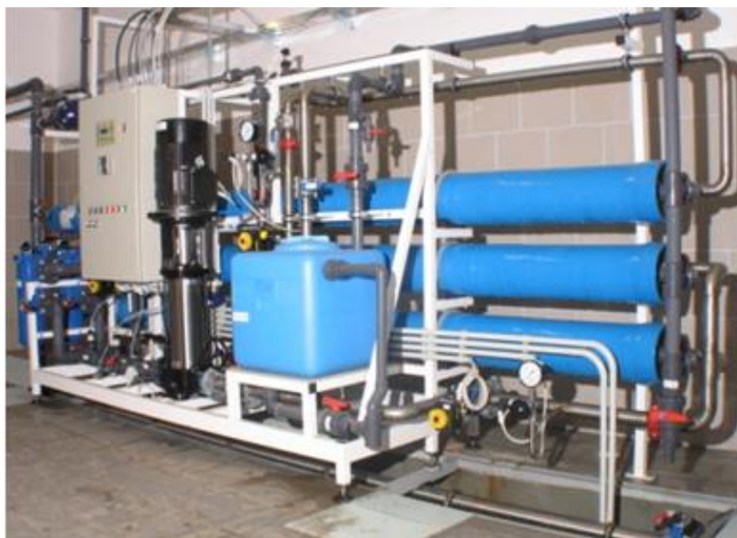
Obr. 4.8 Jednotka RO na ÚV Třebotov [27]
