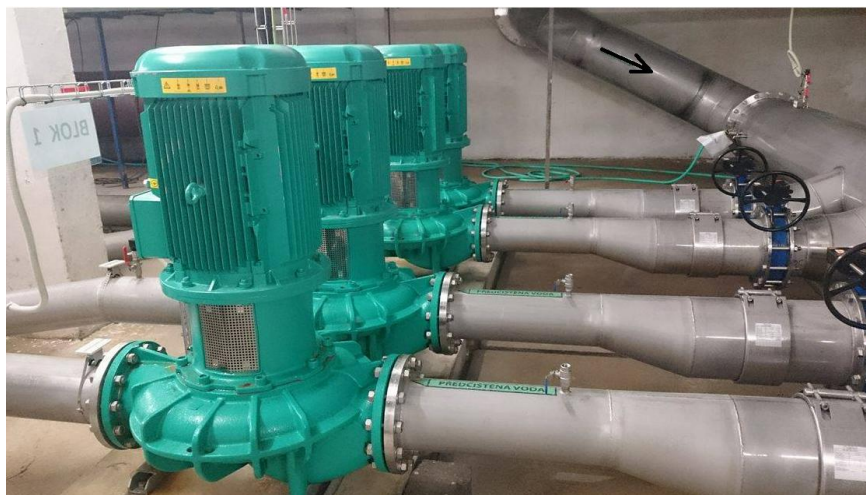
Obr. 4.11 Vstupní čerpadla pro předčištěnou vodu
