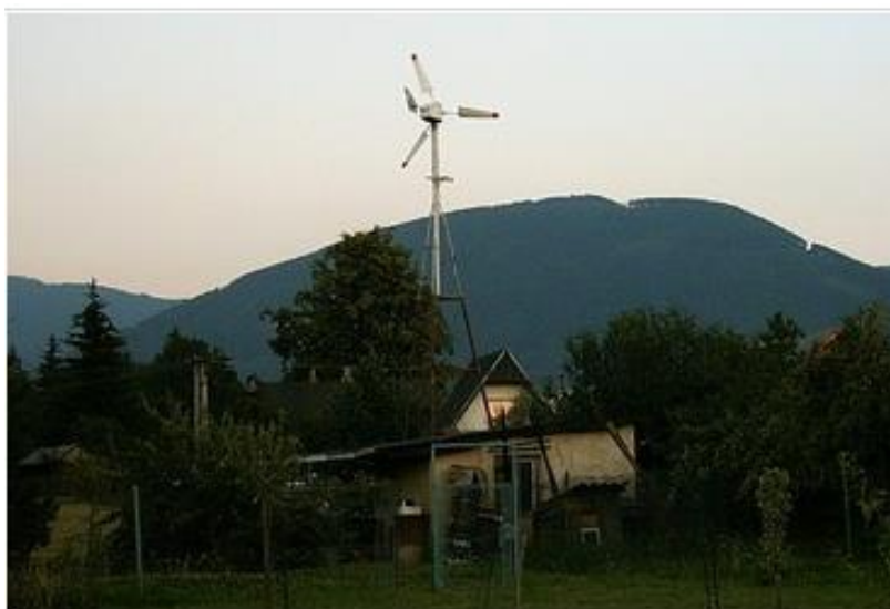
Obr. č. 3: Malá větrná elektrárna s rotorem (Hanslian, 2012)
