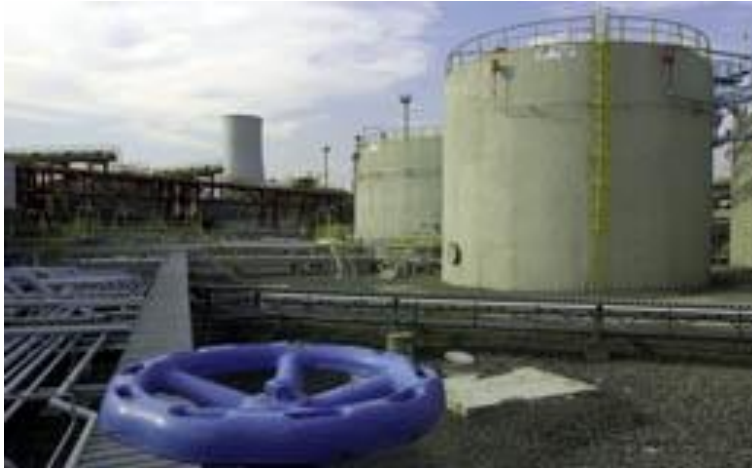
Obrázek č. 4: Nádrže na uskladnění ropy
