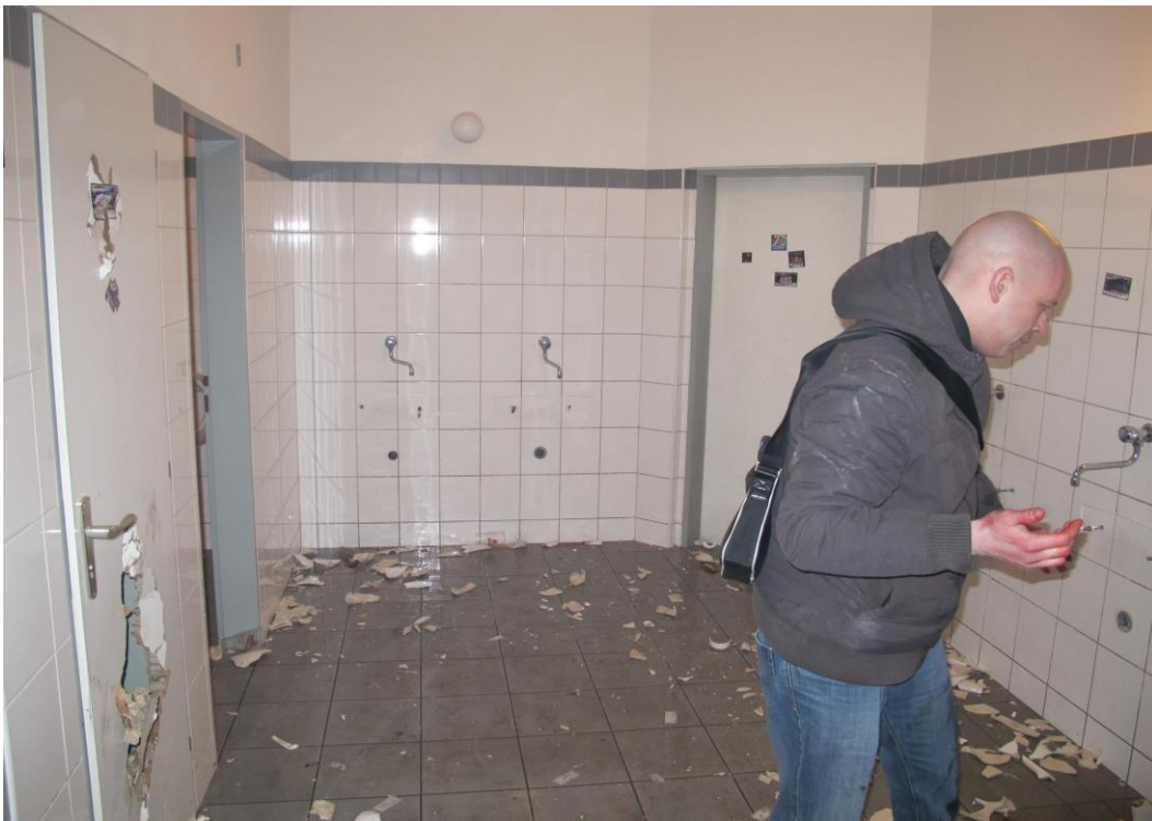
Zničené toalety Androva stadionu, tribuna sever, hostující fans Baníku Ostrava
