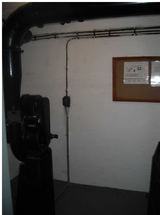
Obrázek 9, pohled do místnosti s FVZ
