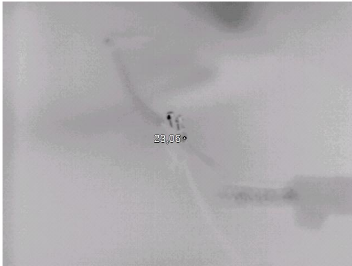
Obr.22: Zahřátí spoje v místě přechodového odporu při utažení svorky na 0,4 Nm
