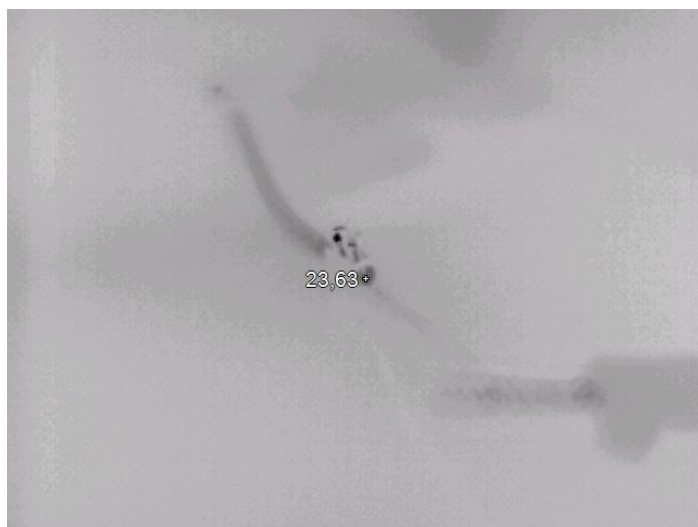
Obr.21: Zahřátí spoje v místě přechodového odporu při utažení svorky na 0,1 Nm
