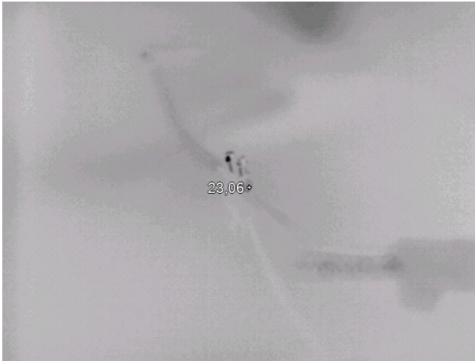
Obr.22: Zahřátí spoje v místě přechodového odporu při utažení svorky na 0,4 Nm
