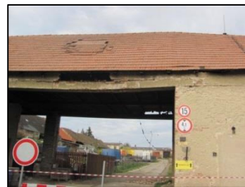
Obrázek 317: Původní vjezdová brána do dvora s narušenou statikou (zdroj: vlastní).
