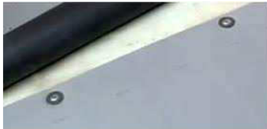
Obr.: 8.3.2 Pohled na kotvicí nýty
