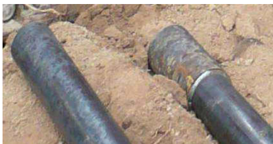
Obr.: 8.2.2 - Pohled na trubkovou armaturu
