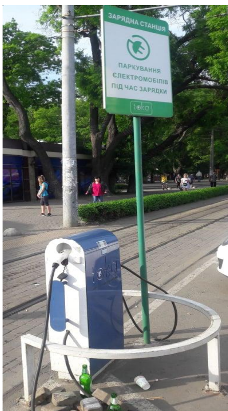
Obrázek 23 - Dobíjecí stanice v Oděse. Foto: vlastní, 2019
