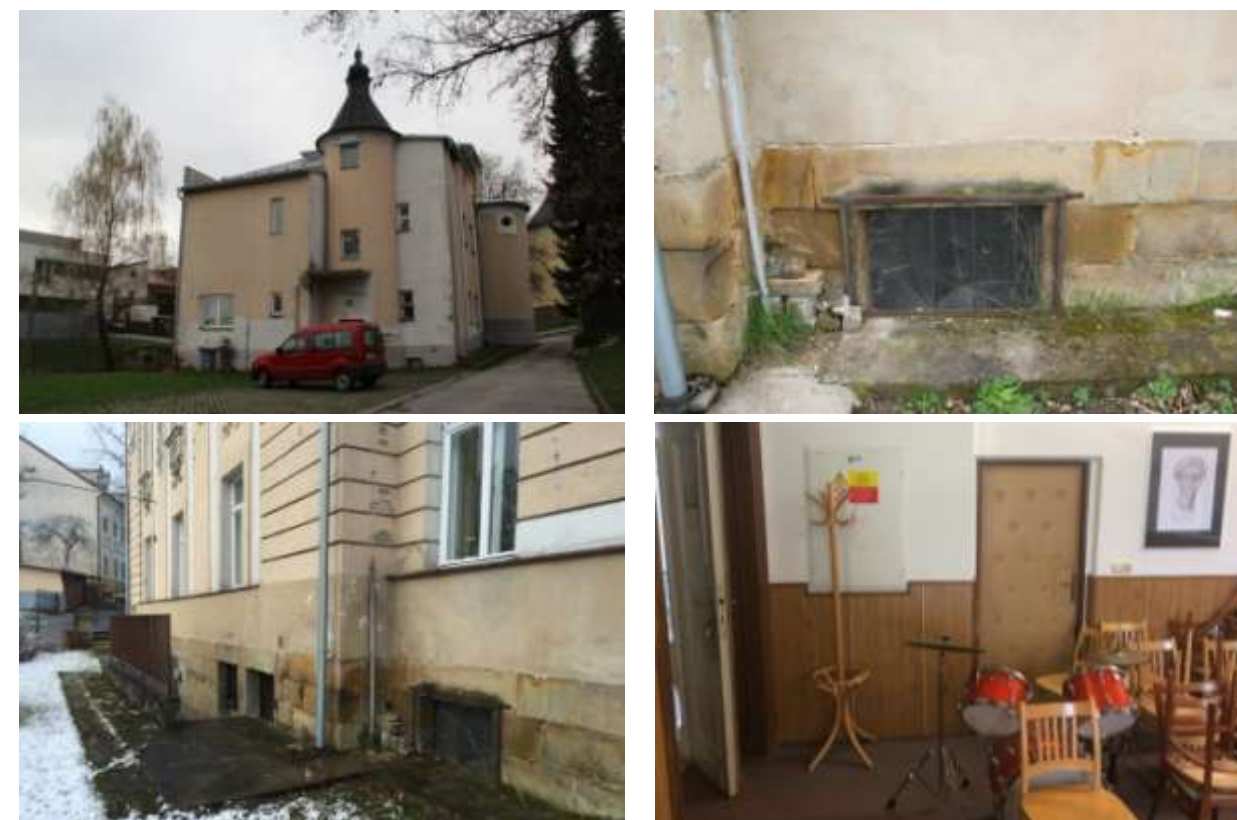
Ukázky nevhodného technického řešení rekonstrukce z r. 1989
