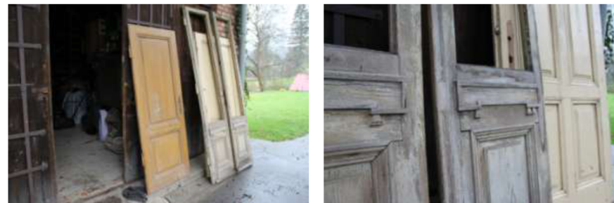
Další dveře, na snímku vpravo detail dveří na balkoně v kuchyni. Stav po 60 letech působení povětrnostních vlivů a 60 letech skladování
