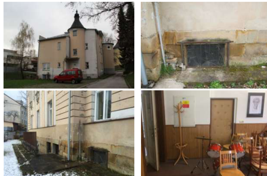
Ukázky nevhodného technického řešení rekonstrukce z r. 1989
