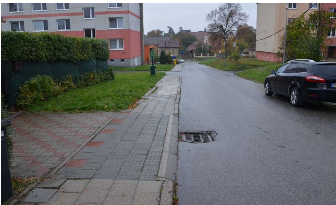
Obrázek 2: Komunikace 01 – deformace v okolí uličních vpustí
