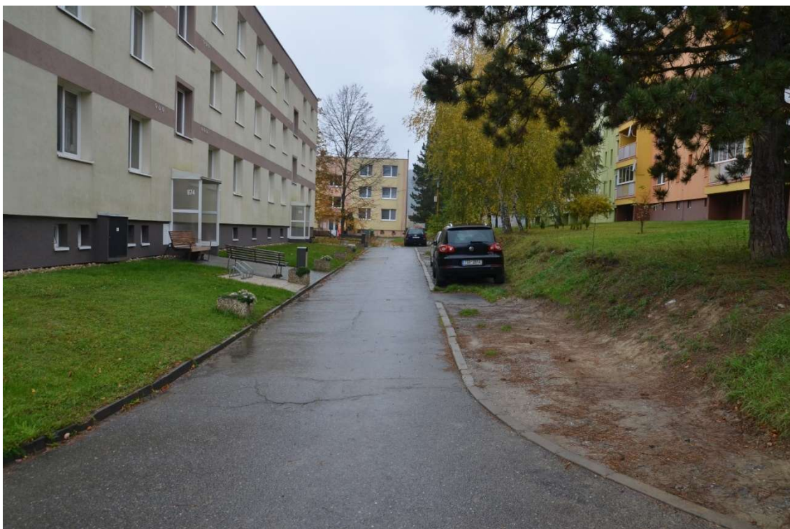
Obrázek 3: Komunikace 02 – příčné trhliny
