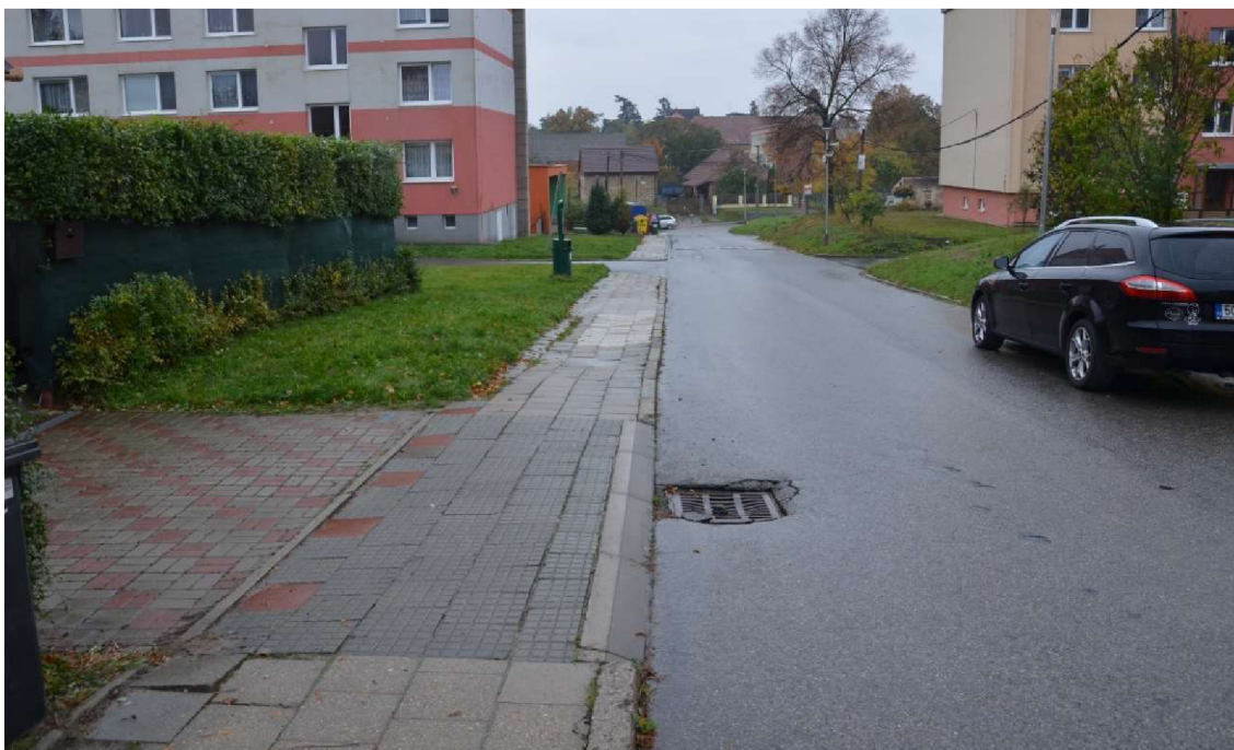
Obrázek 2: Komunikace 01 – deformace v okolí uličních vpustí
