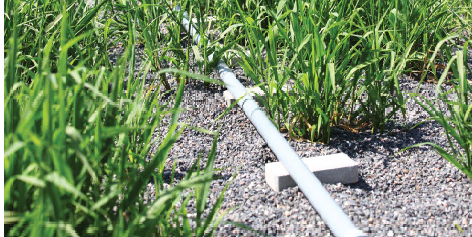
↑ obr. 6 Kořenová čistírna (Vodní hospodářství 2023)
