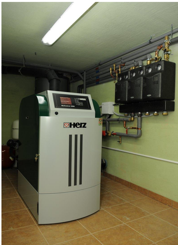
Obr. 25 Technická miestnosť po rekonštrukcii
