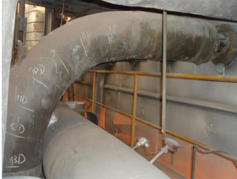
Obrázek 32 - Potrubí vedoucí páru (300 °C) s cementovou izolací
