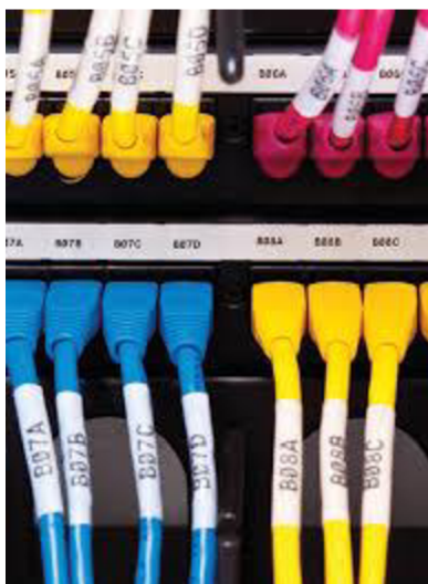
Obrázek 21: Identifikační značení kabeláže
