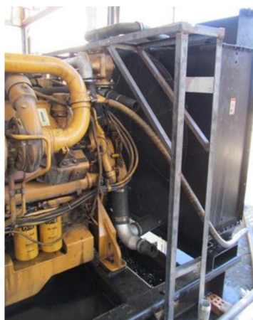
d) dieselgenerátor CAT, jehož odpadní teplo sloužilo pro provoz jednotky
