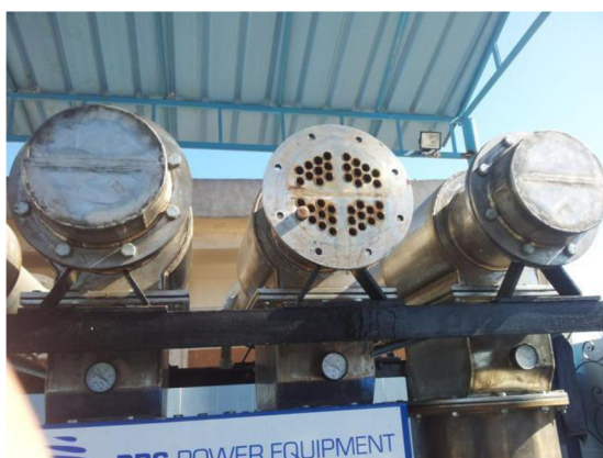
c) závada na trubce kondenzátoru po několika měsících provozu
