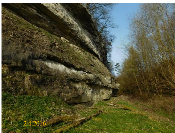
Fotografie 21: Skalní převisy u silni II. třídy 268, v PP Skalní sruby Jizery
