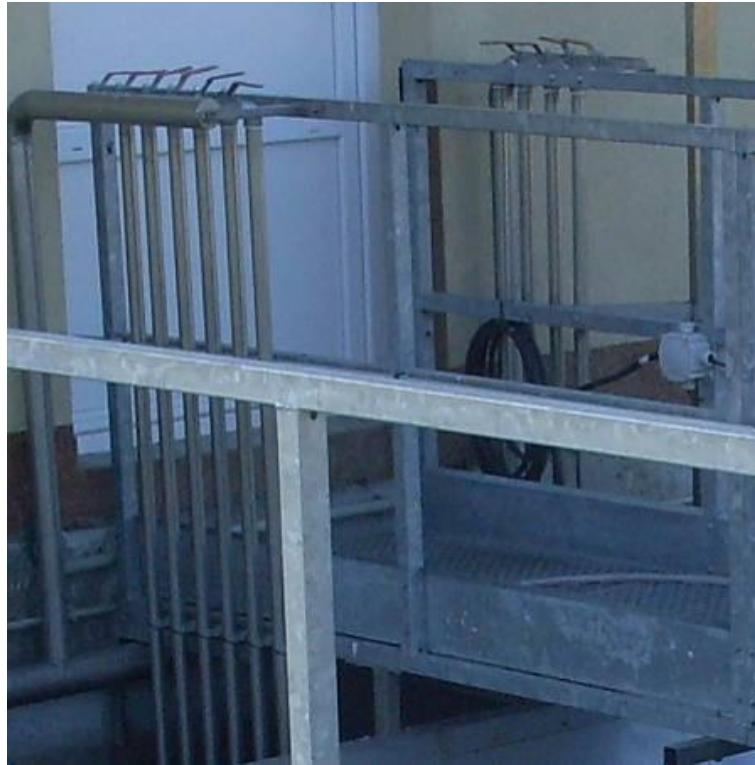
Foto č. 7: Ventily ovládající dodávku vzduchu do jednotlivých větví provzdušňovacího systému, zdroj vlastní
