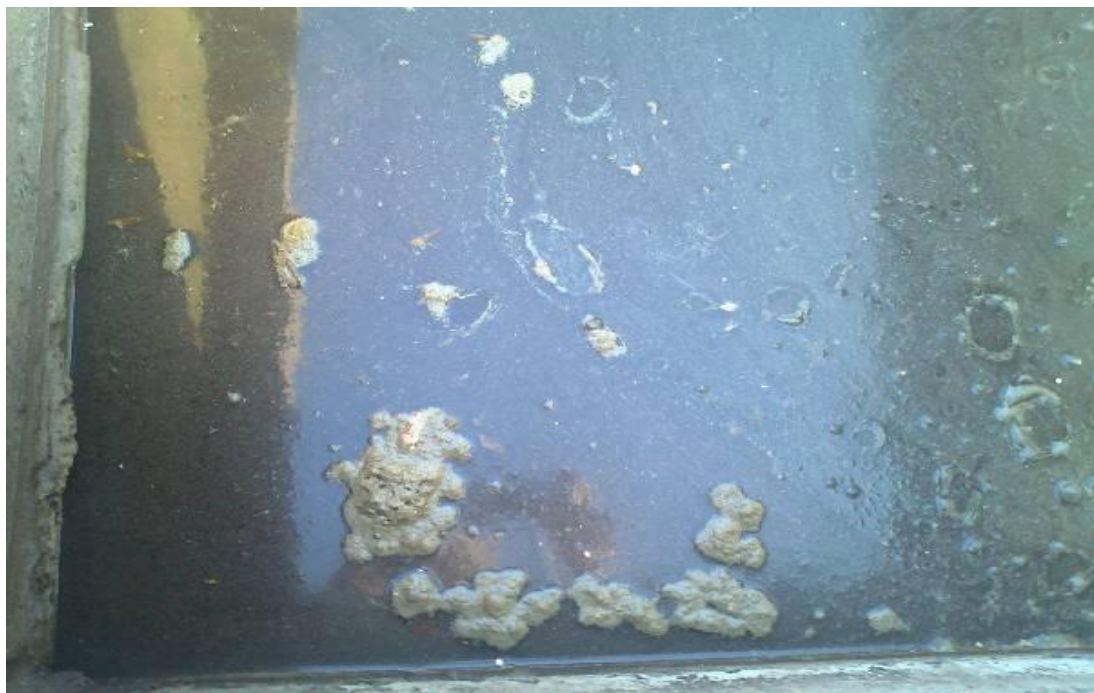
Foto č. 5: Pohled do denitrifikačního prostoru, zdroj vlastní
