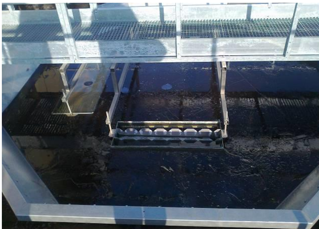
Foto č. 8: Dosazovací část ČOV Semtěš, zdroj vlastní
