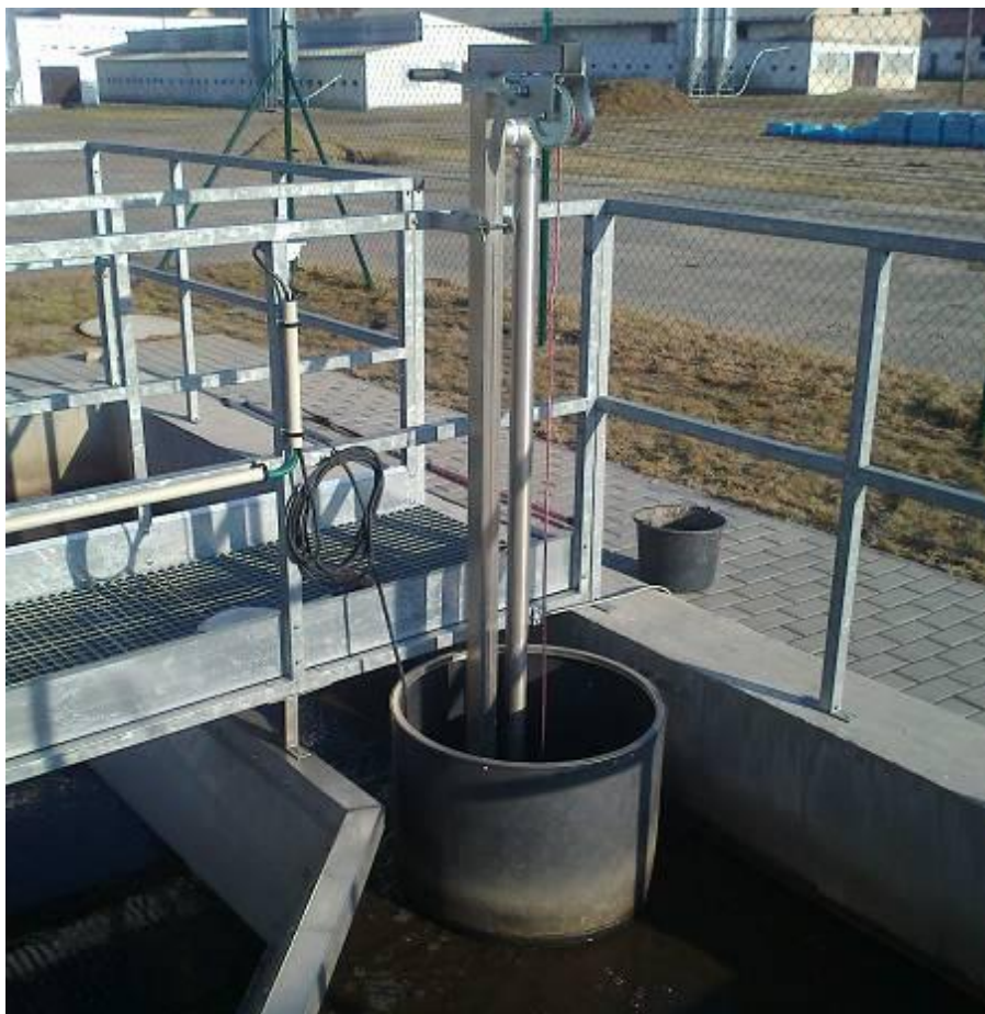
Foto č. 9: Předzahušťovač kalu ČOV Semtěš, zdroj vlastní
