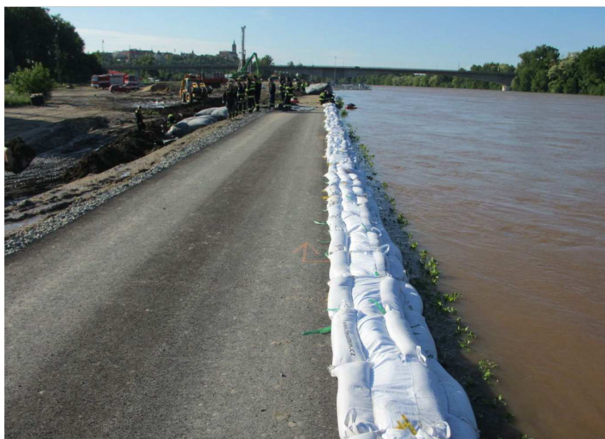
Obr. 8 Sypaná hráz v lokalitě Přístav během povodně v červnu 2013 (MŽP 2013a)
