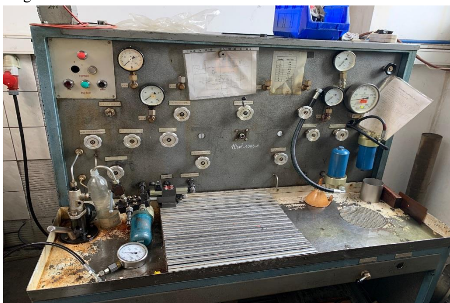
Obr. 3 Zkušebna pro rozvaděče a ventily ve firmě Glentor
