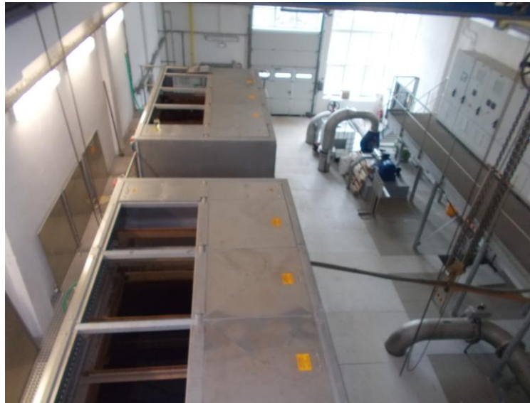
Obr. č. 14 Kalové hospodářství ÚV Mostiště – flotační jednotky (Zdroj: autorka práce)
