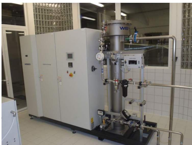
Obr. č. 12 Výroba ozonu na ÚV Mostiště (Zdroj: autorka práce)
