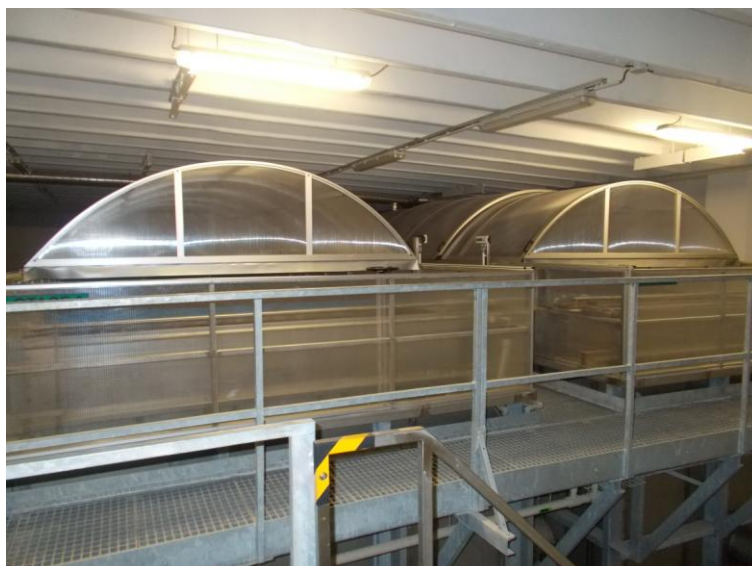
Obr. č. 9 Flotační jednotky na ÚV Mostiště (Zdroj: autorka práce)
