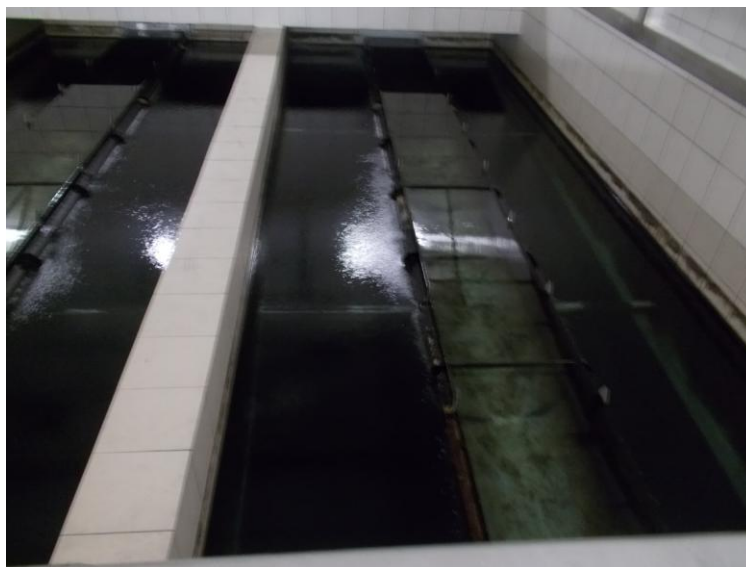
Obr. č. 13 GAU filtrace na ÚV Mostiště (Zdroj: autorka práce)
