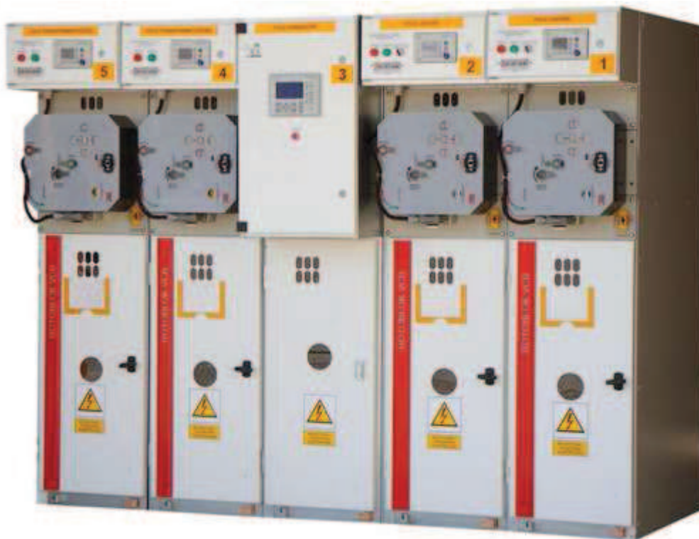
/Obr. 6.22/ Kiosková trafostanice
