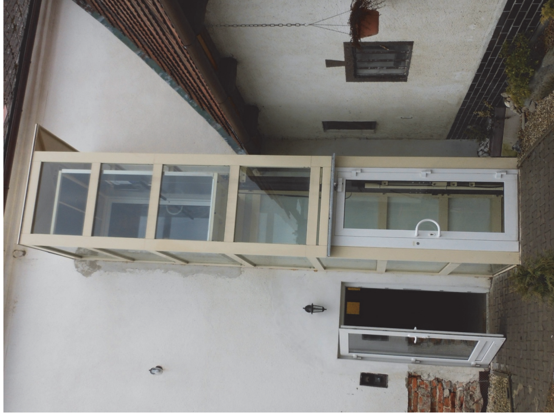
Příloha č. 10 Fotografie nainstalované plošiny u respondenta R1
