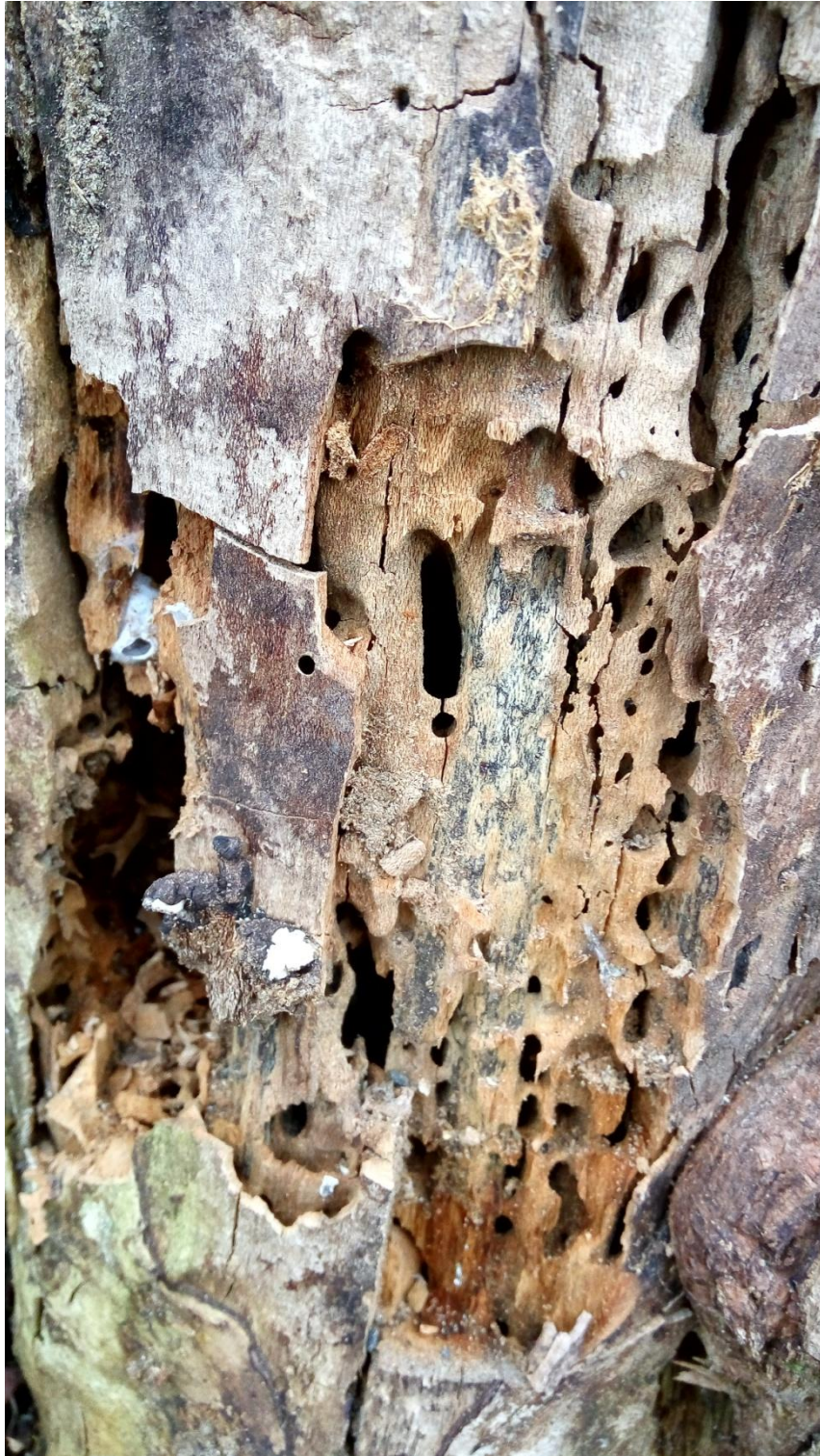
Obrázek č. 14 – Poškození dřevokazným hmyzem (foto: K. Fraňková)
