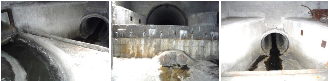
Obrázky 65, 66, 67: Odlehčovací komora č. 13, Dolní Kamenná, u McDonaldu, přepadová hrana z oceli.
