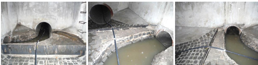
Obrázky 32, 33, 34: Odlehčovací komora č. 12, Dolní Kamenná, u Hypernovy, s přepadem přímým kolmým.
