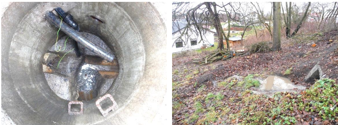
Obrázky 95, 96: OK č. 49, Merlínská/Rosnická ul., komora s napojením výtlačného potrubí s vyhledávacími vodiči; výustní objekt.
