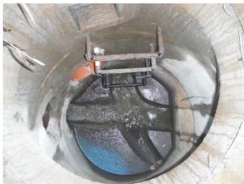
Obrázek 44: Odlehčovací komora č. 51, Lesov, u můstku, s přímým odlehčením při vzduté hladině.
