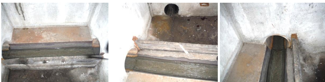
Obrázky 61, 62, 63: Odlehčovací komora č. 50, Sadov, za zastávkou, přeřadová hrana dřevěná.
