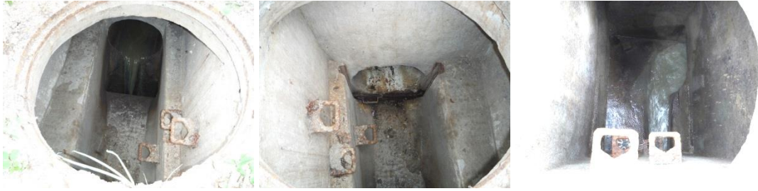
Obrázky 38, 39, 40: Odlehčovací komora č. 35, Hamerská ul., u mostu, spadišťová s přepadajícím paprskem.
