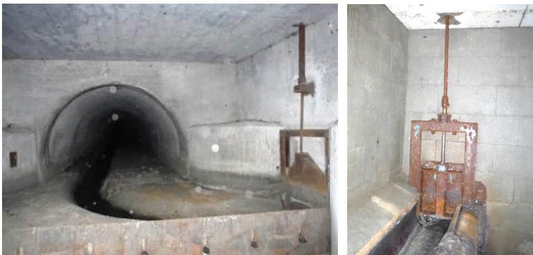
Obrázky 1, 2: Ukázka stavítka s mechanickou regulací na odtoku, odlehčovací komora č. 13, Dolní Kamenná, u McDonaldu; ukázka stavítka s mechanickou regulací na odtoku, odlehčovací komora č. 52, Háje, u mostu.
