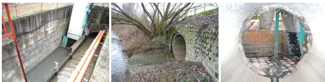
Obrázky 8, 9, 10: OK, výustní objekt, automatizované česle na ČOV v Karlových Varech – Drahovicích.
