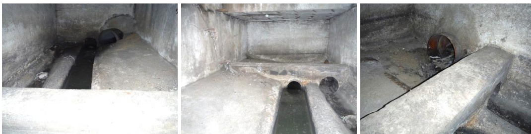
Obrázky 26, 27, 28: Odlehčovací komora č. 23, Hlavní/Všeborovická ul., u masny, s přepadem jednostranným bočním s přímou hranou.
