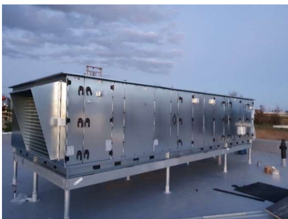
Obr. 2 Exteriérová VZT jednotka
