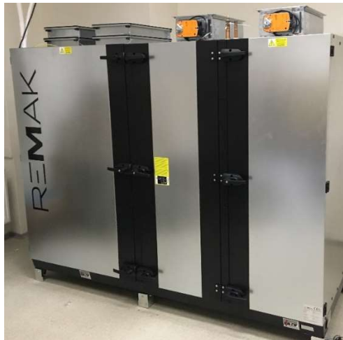
Obr. 5 VZT zařízení se sáním/výtlačem na vrchním plášti
