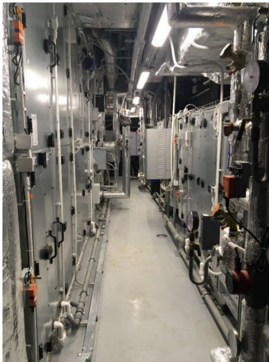
Obr. 1 Interiérové jednotky umístěné ve strojovně VZT
