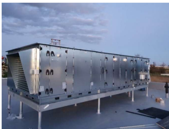
Obr. 2 Exteriérová VZT jednotka
