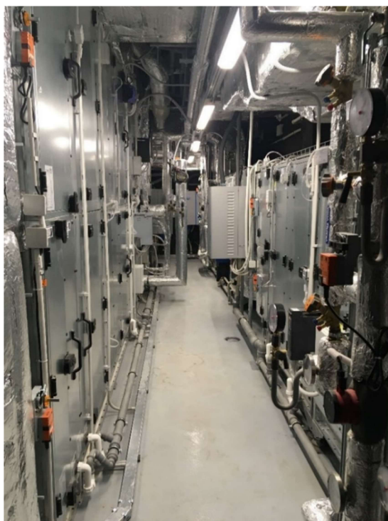
Obr. 1 Interiérové jednotky umístěné ve strojovně VZT
