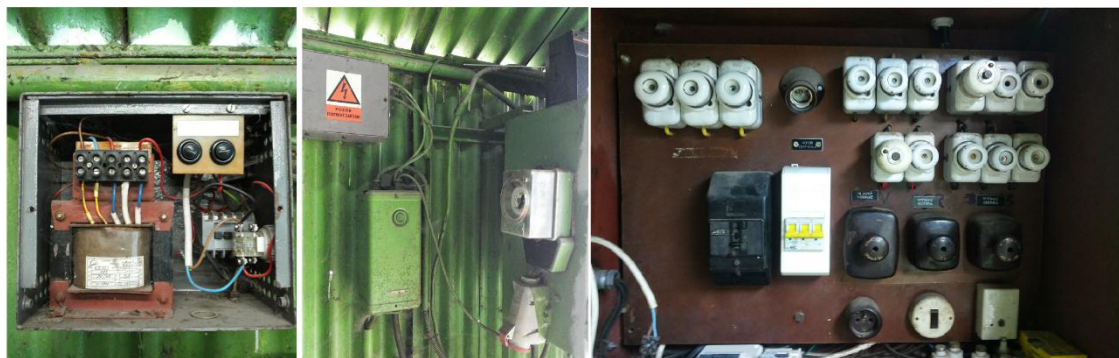
Obr.4 Súčasný stav elektroinštalácie
