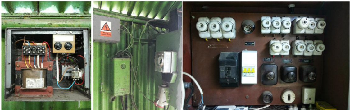
Obr.4 Súčasný stav elektroinštalácie
