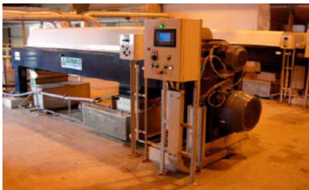
Obrázek č. 7- Strojní odvodnění kalu, sušení kalu
