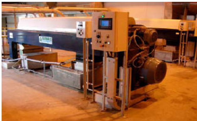
Obrázek č. 7- Strojní odvodnění kalu, sušení kalu
