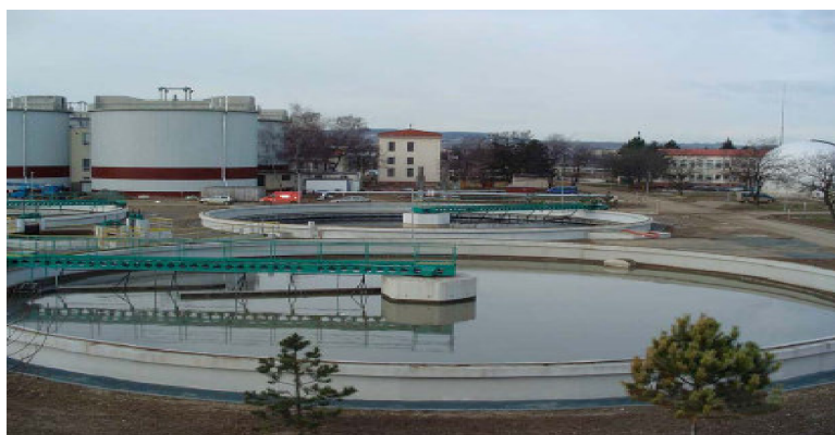
Obrázek č. 5 – Usazovací nádrže
