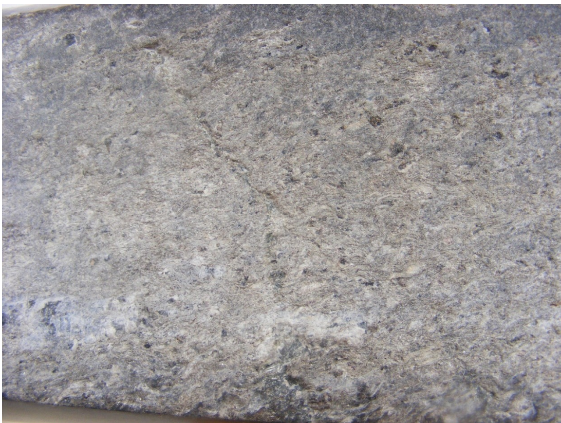
Obr. č. 3: Detail prasklin
